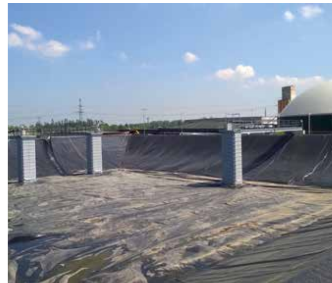
Gasdichte schwimmende textile Abdeckung 25000 m 3
