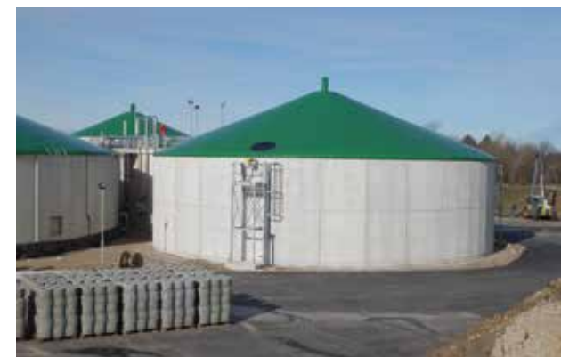
Biogasdach auf Stahlbetonbehälter
