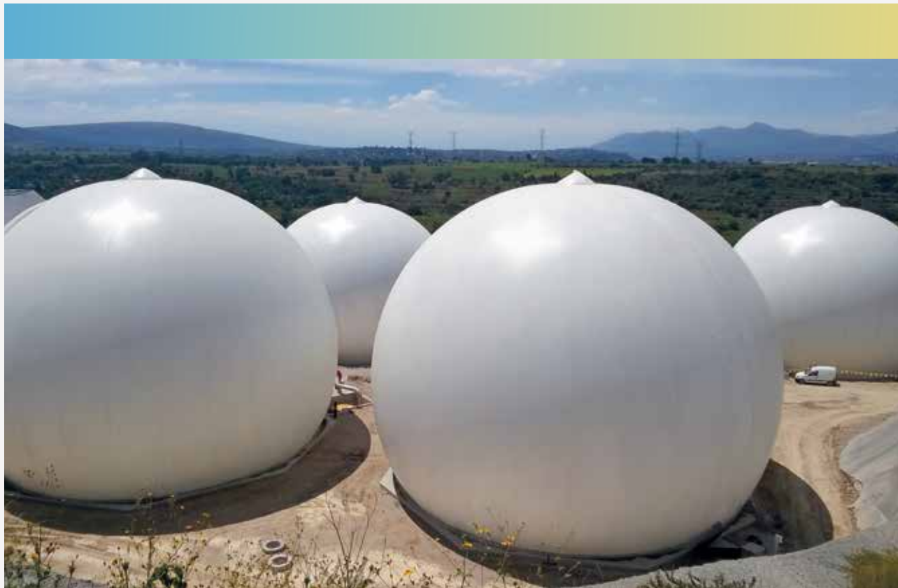
3/4-Speicher, 7 mal 8500 m³
